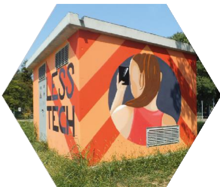
Torino e Parma, Italia IRETI SPA Schermatura delle cabine di trasformazione MT/BT (rif DPCM 08/07/2003)
